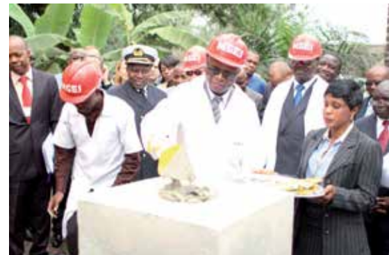
Le Ministre étalant le mortier avant de poser la première pierre. A sa droite le Directeur du Centre, à sa gauche le SG/CICOS
